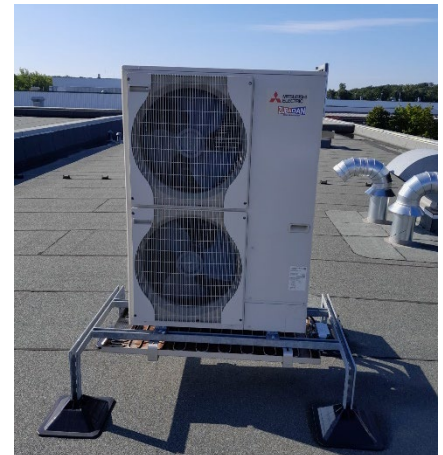
Wärmepumpe für Futterhaus Gardelegen
