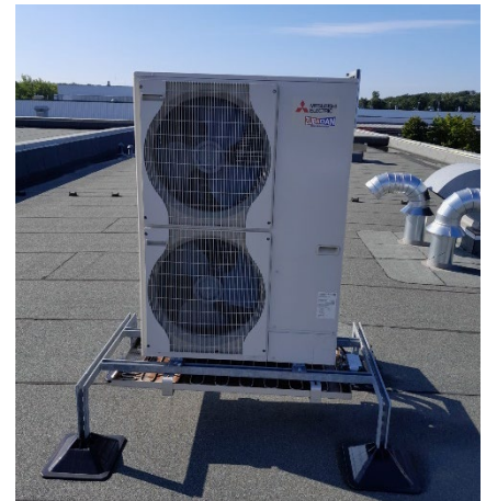
Wärmepumpe für Futterhaus Gardelegen
