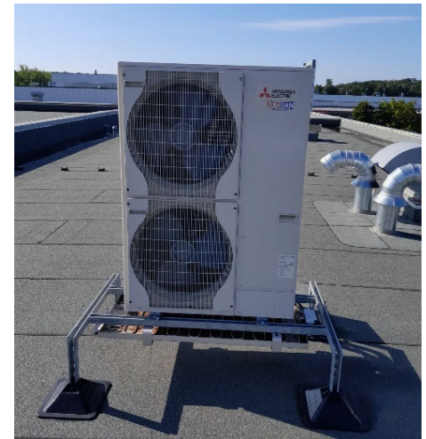
Wärmepumpe für Futterhaus Gardelegen
